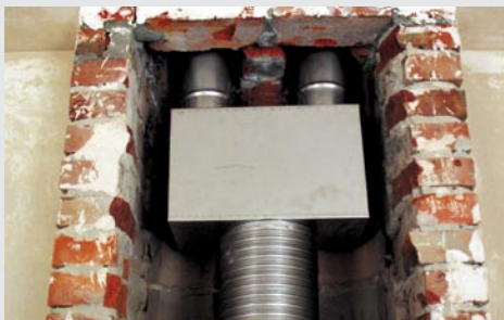
Komin „poprawiony” poprzez włożenie w dwa kanały rur, połączenie ich za pomocą kolektora z rurą spalinową i wkładem kominowym.
