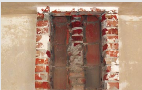
Z kominą częściowo usunąłem nieszczerne kształtki.
